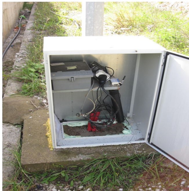
Εικόνα 2. Σταθμός μέτρησης κυκλοφορίας Τύπου I
