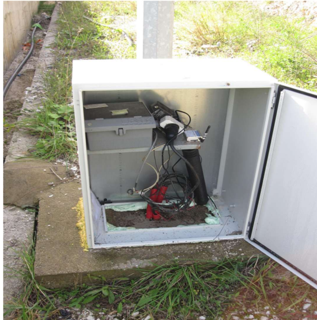
Εικόνα 2. Σταθμός μέτρησης κυκλοφορίας Τύπου I
