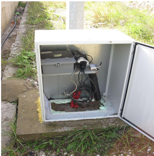
Εικόνα 2. Σταθμός μέτρησης κυκλοφορίας Τύπου I
