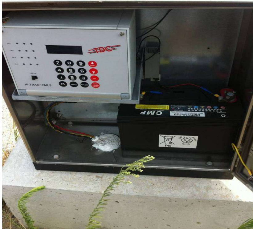
Εικόνα 3. Σταθμός μέτρησης κυκλοφορίας Τύπου ΙΙ
